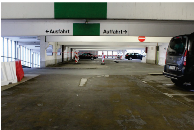
Sanierungsbedürftiges Parkhaus Hornsche Straße
